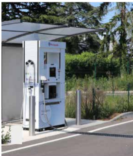
Station hydrogène des Loges, près de Versailles
